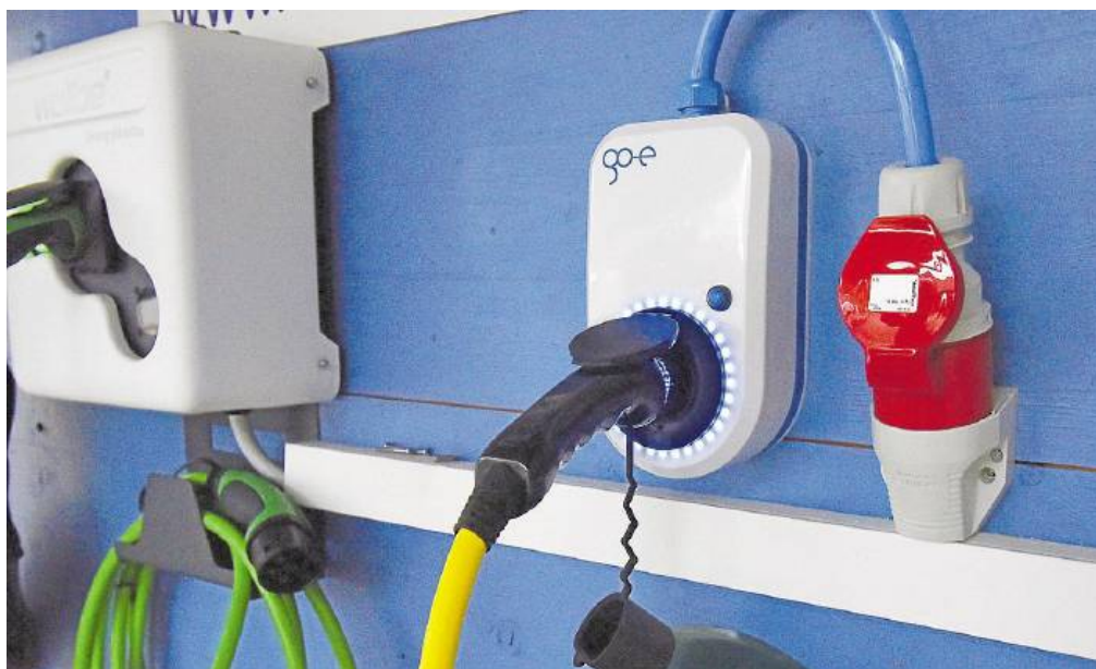
Jörg Tappeser hat verschiedene „Stromtankstellen“ an seinem Carport installiert. Er kann mehrere Autos gleichzeitig betanken.
